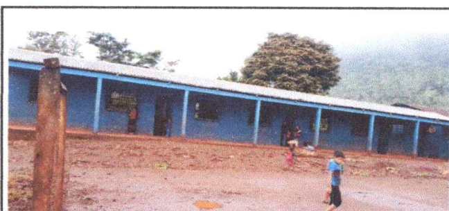
Foto 6: se observa humedad avanzada en la pared.
